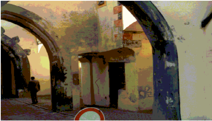
Das Bayertor in Landsberg 5 Jahre nach der Sanierung! Feuchteschäden bis über 3 Meter hoch mit sogenanntem »Entfeuchtungsputz«
